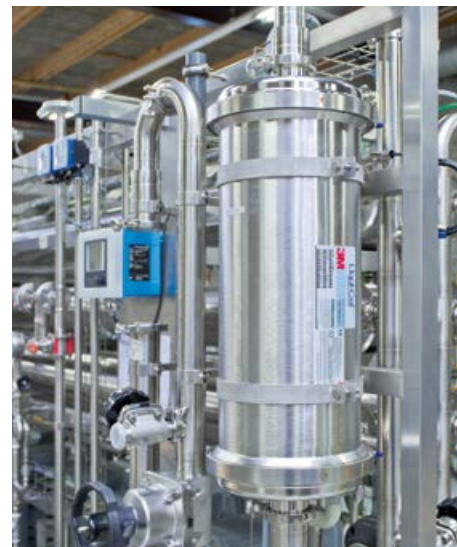
De ontzouting vindt plaats in twee stappen. (Foto's Ovivo)
